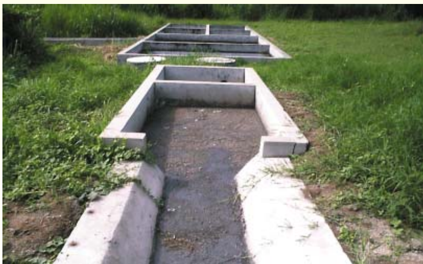
บ่อบำบัดน้ำเสีย
